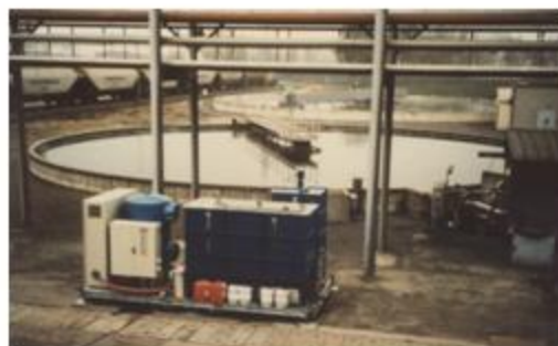
Plate forme de traitement d'eau
